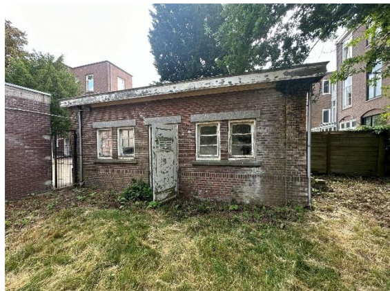
Garage geheel destructief onderzocht
